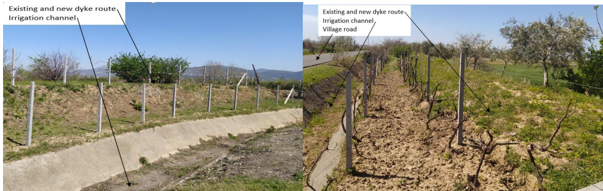
Figura 5.18 Foto të rrugës të aksesit dhe kanalit të kullimit përgjatë gjurmës të argjinaturës të re dhe ekzistuese
